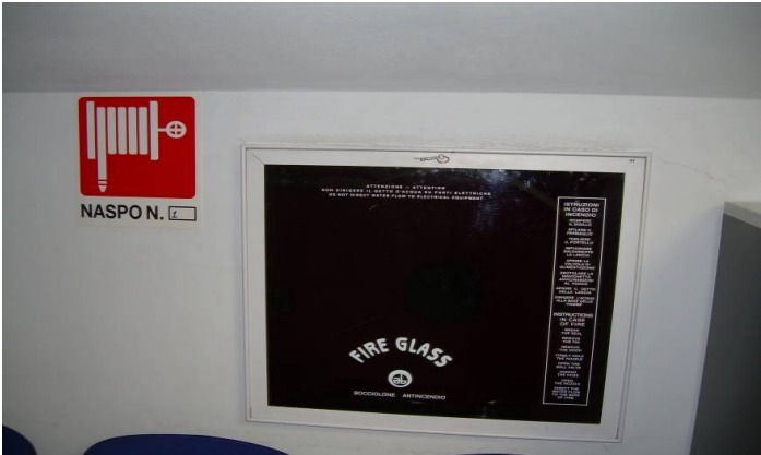
Idranti interni installati nei vari locali
