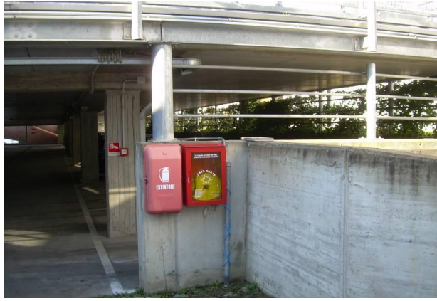
Idrante esterno installato nel parcheggio auto dipendenti
