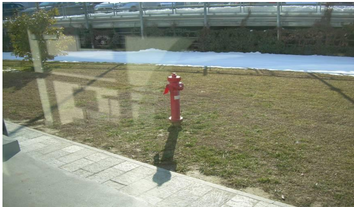
Idrante nel cortile interno
