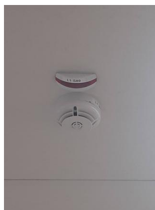
Rilevatori di fumo
