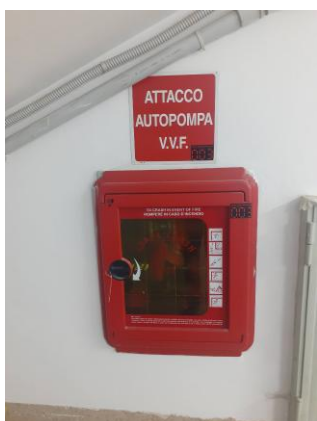
Vista attacco motopompa VVf
