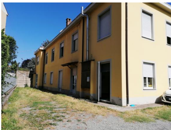
Localizzazione dei due distinti box esterni di alloggiamento caldaie
