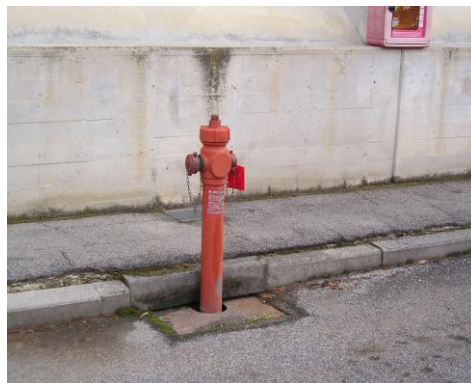
Colonnina idrante esterna
