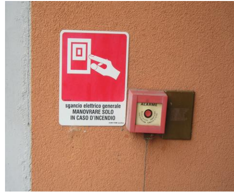
pulsante di sgancio elettrico generale all'esterno della struttura
