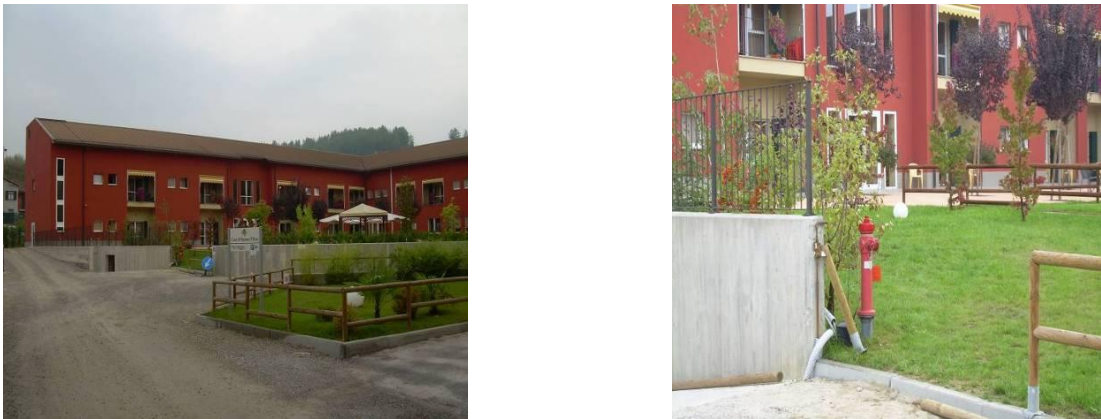
Idrante esterno installato nel giardino della Casa di Riposo, nei pressi della centrale di pompaggio
