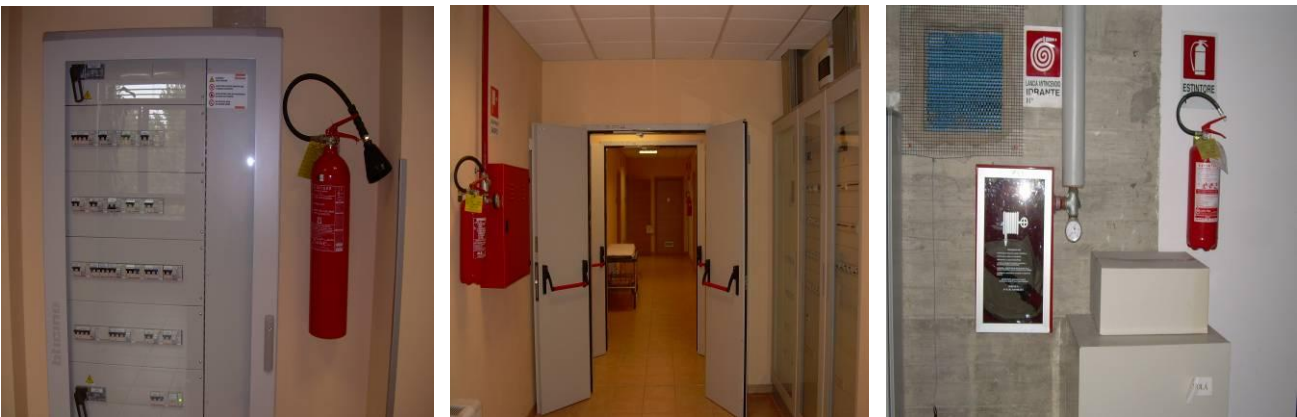
vista alcuni estintori portatili (a polvere/CO 2 ) e naspi installati
