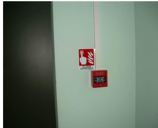
Pulsante allarme incendio
