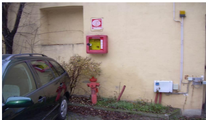
Idrante esterno installato nel parcheggio auto dipendenti
