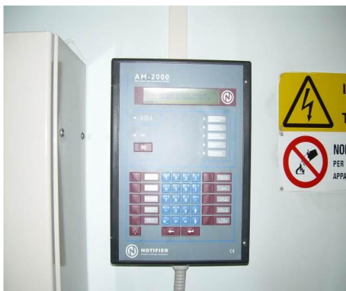
Centrale Rilevazione Incendi
