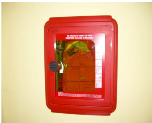
Idrante interno installato nei locali del C.T.P
