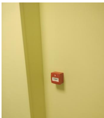
Pulsanti allarme antincendio
