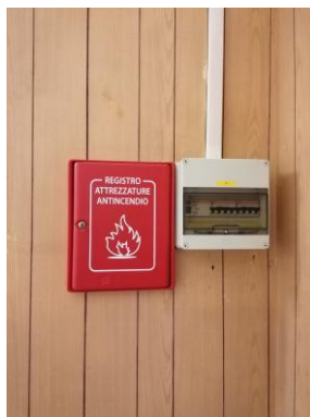
Cassetta registro antincendio
