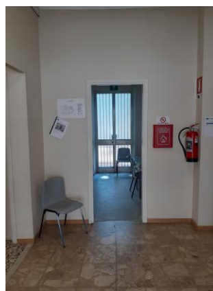
cassetta contenente il registro antincendio
