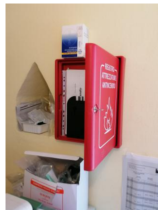
cassetta contenente il registro antincendio
