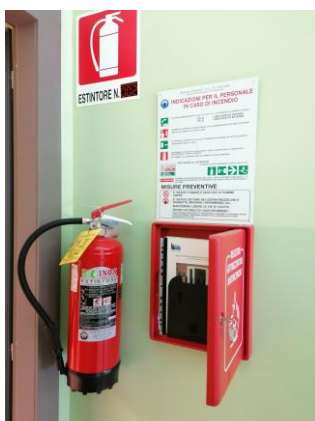
Estintore, cartellonistica e cassetta contenente il registro antincendio
