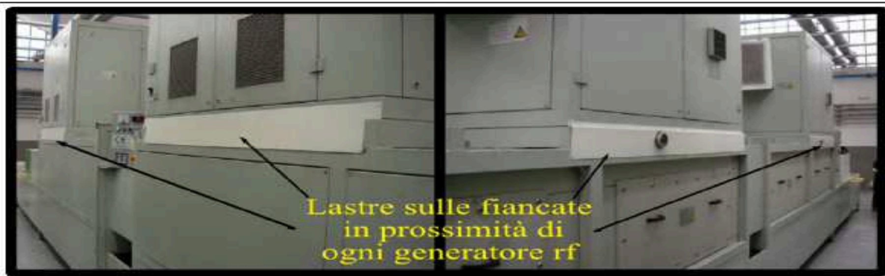
Fig 1: Lastre aggiunte ad ogni fiancata dei macchinari in prossimità di ogni generatore a radiofrequenza per contenere le emissioni elettromagnetiche sui lati.
