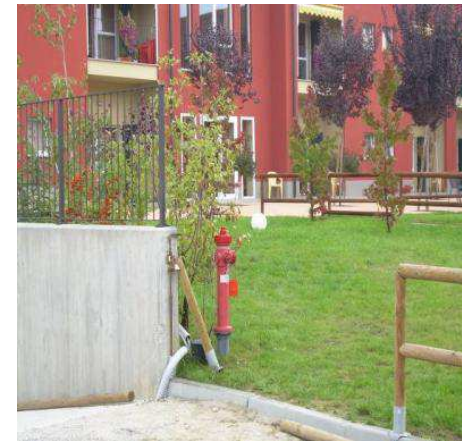
idrante soprasuolo installato a Canale
