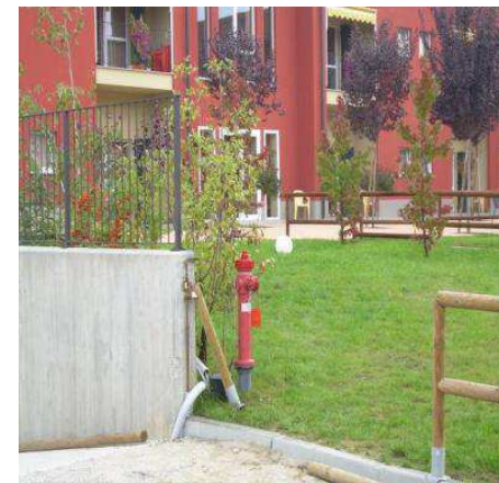
idrante soprasuolo installato a Canale
